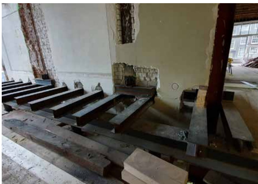
De ondersteuningsconstructie bestaat uit een soort 'trambanen' van stalen balken en liggers.
